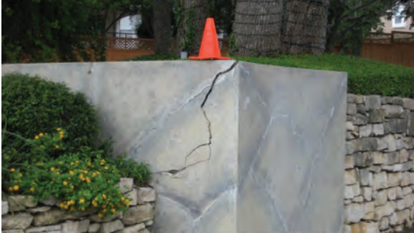
Şekil 21. Height Drive bölgesinin girişinde ve boşluk yapısının üzerinde yer alan mermer bloğunda gözlenen deformasyon.
