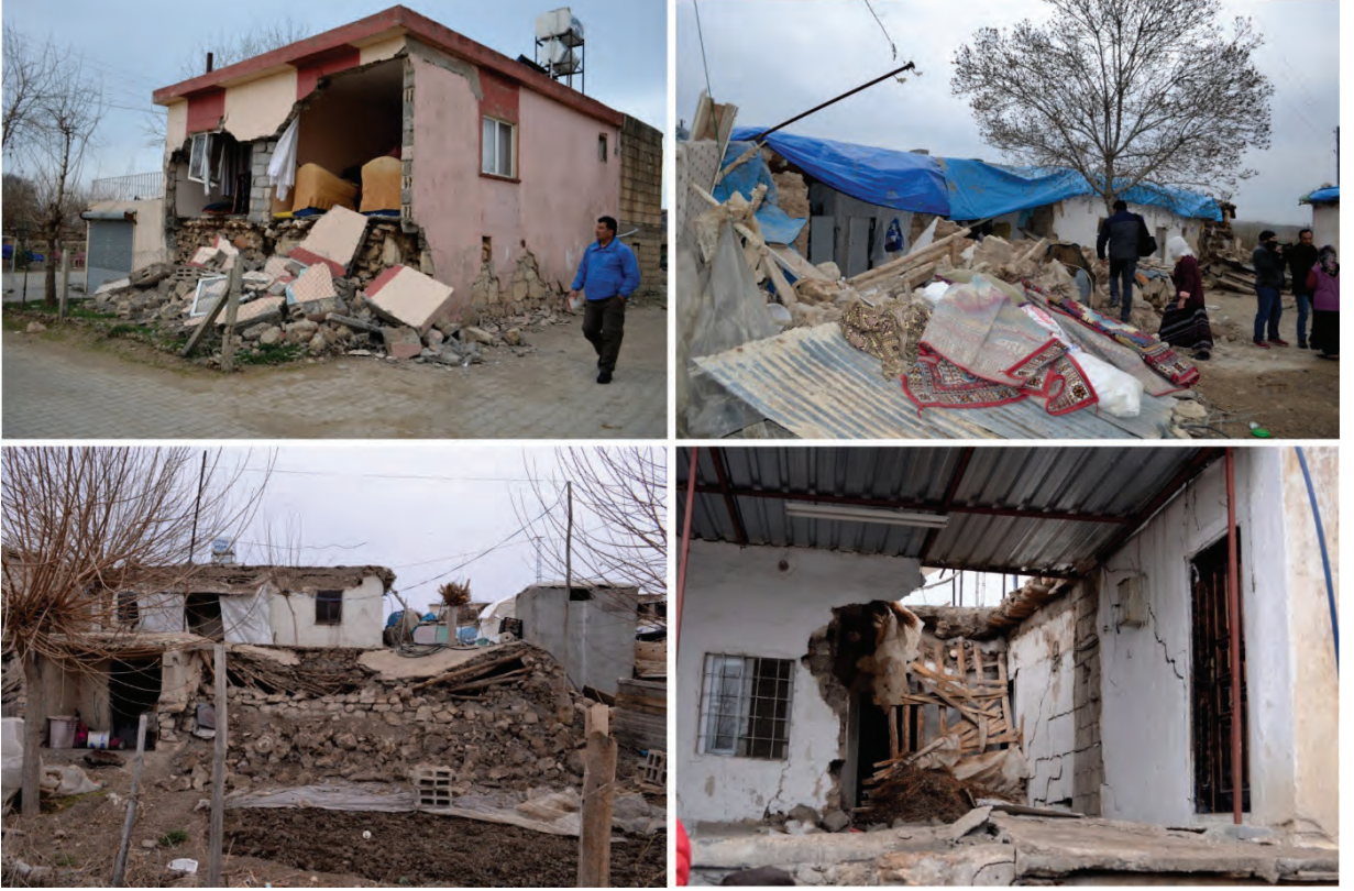
Şekil 4. 2 Mart 2017 depreminden sonra Samsat kuzeyinde Akdamar ve Taşkuyu köylerinde oluşan yapısal hasarlar. Figure 4. Structural damages in Akdamar and Taşkuyu villages located in north of Samsat after 2 March 2017 earthquake.
